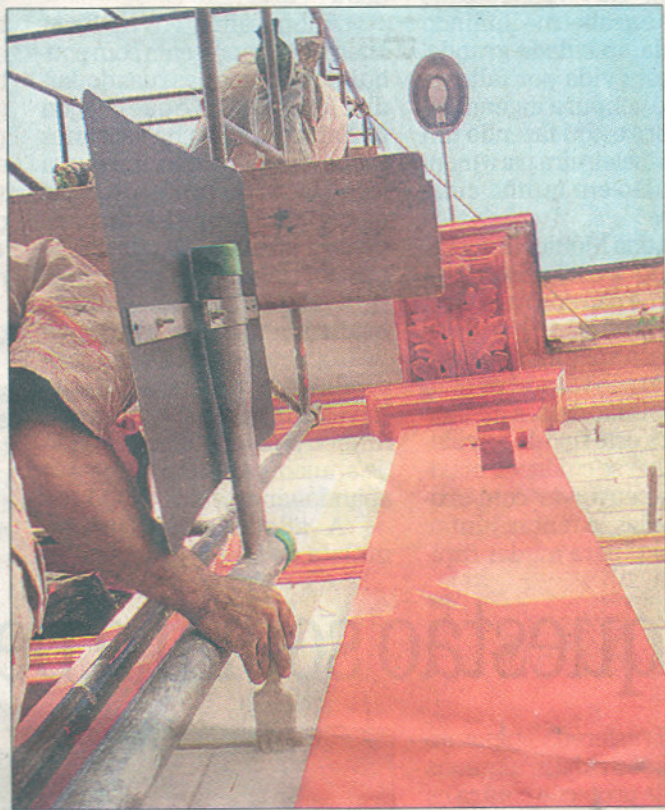
Operário trabalha na restauração do Giovannetti II
