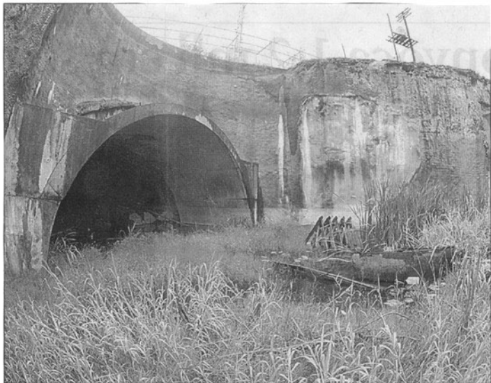
Túnel 2, na Vila Industrial: diretor da Defesa Civil disse que vai “verificar” o problema
