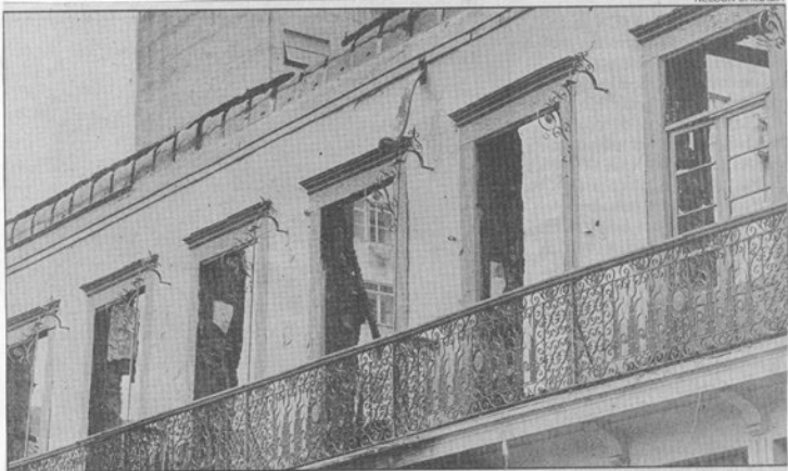
Parte da fachada do Solar: depósito pode ser cobrado de quem for responsabilizado criminalmente
