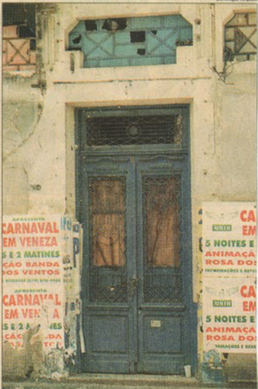
Porta destruída do solar: restos sem valor histórico
