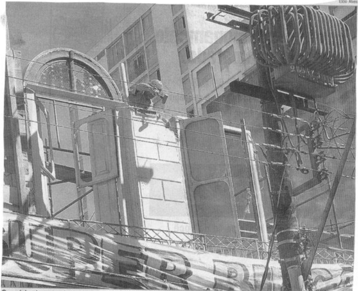
Operário desmancha uma das paredes do prédio da Pólo Norte: trabalho concluído dentro do prazo
