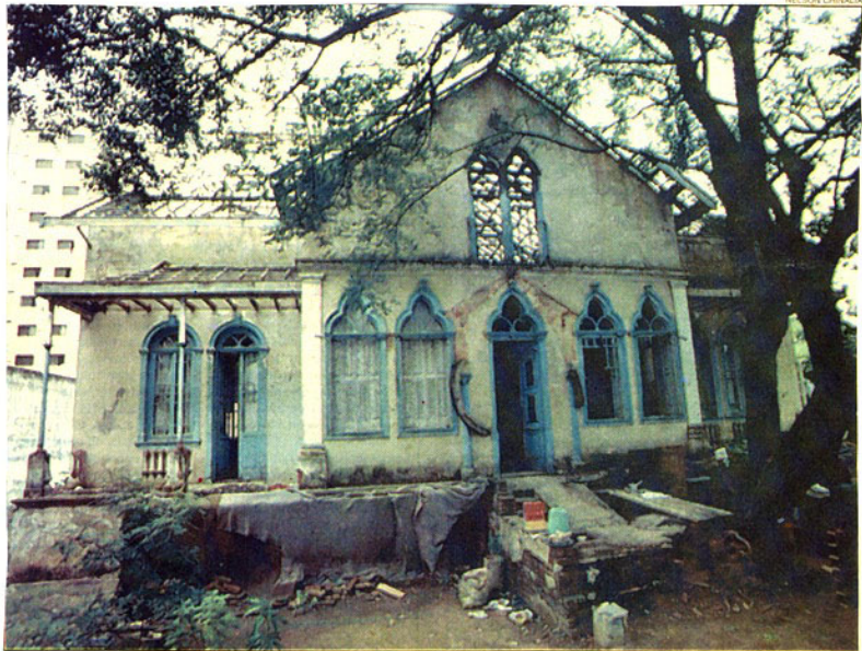
Os dois projetos apresentados à Santa Casa incluem a restauração do casarão, que hoje está em péssimo estado de conservação
