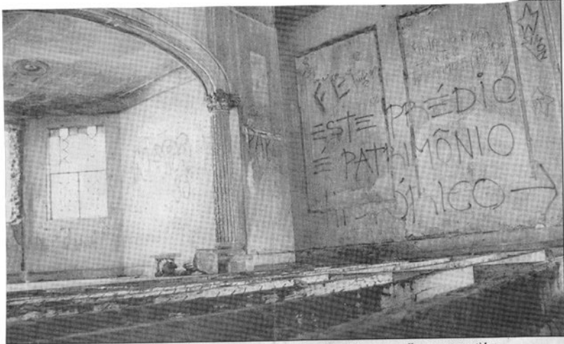
Interior do casarão da Rua Padre Vieira: paredes sustentadas por vigas de madeira e assoalhos comprometidos
