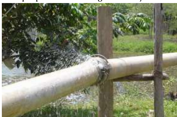
Figura 245: Vazamento em tubos metálicos de irrigação.
