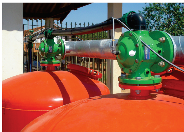
Figura 24. Detalhe de uma válvula de retrolavagem instalada na parte superior de um filtro.
