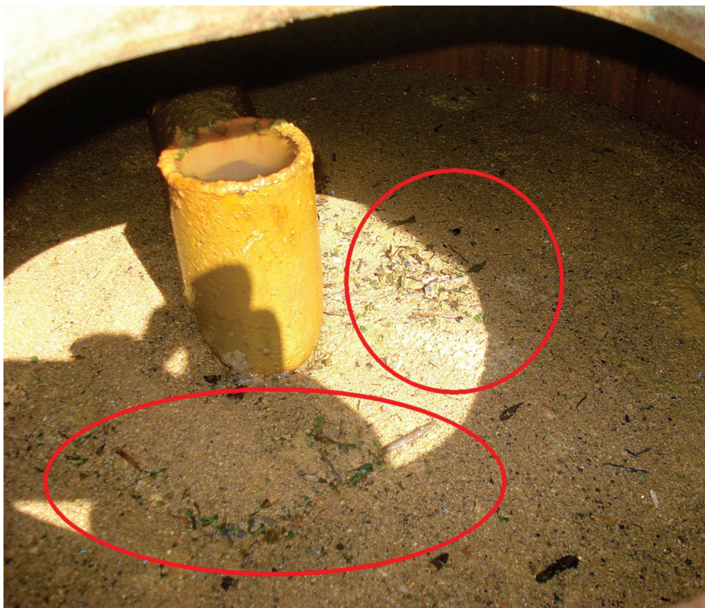
Figura 6. Interior de um filtro de areia após um processo de filtração, com detalhes de material orgânico retido na sua superfície.
