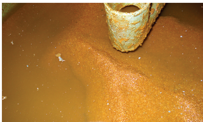
Figura 16. Detalhe da movimentação de areia no interior de um filtro operando no campo a uma taxa de filtração elevada.
