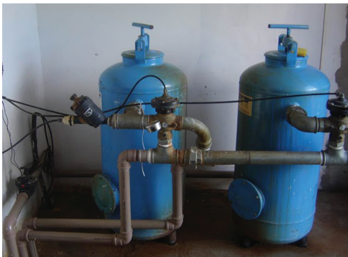
Filtros de areia na irrigação localizada
