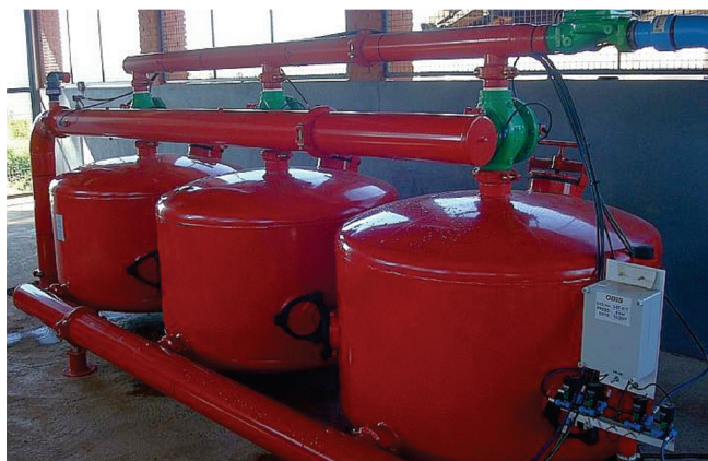
Figura 25. Dois exemplos de conjunto de filtros de areia montados e em operação.
