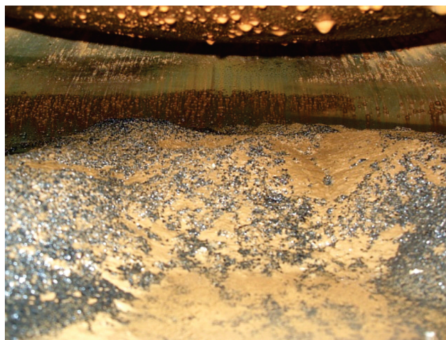
Figura 19. Detalhe da superfície da areia no interior de um filtro após a retrolavagem mal realizada.
