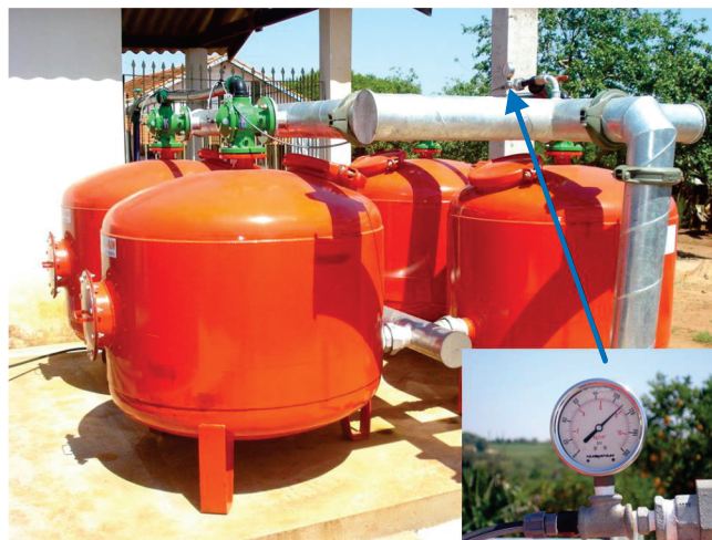
Figura 30. Detalhe de um conjunto de quatro filtros com manômetro.
